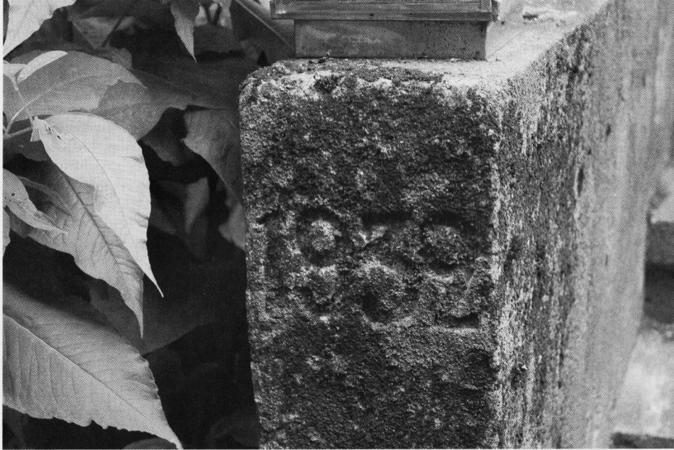
Päärakennuksen betoniporras on ajan patinoima, mutta siitä erottuu vielä talon valmistumisvuosi 1932.
